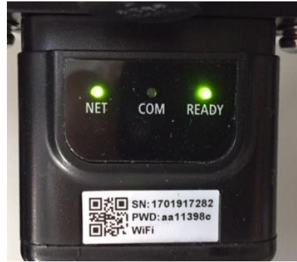
Figura 71 - Stato di comunicazione irregolare tra inverter e scheda
