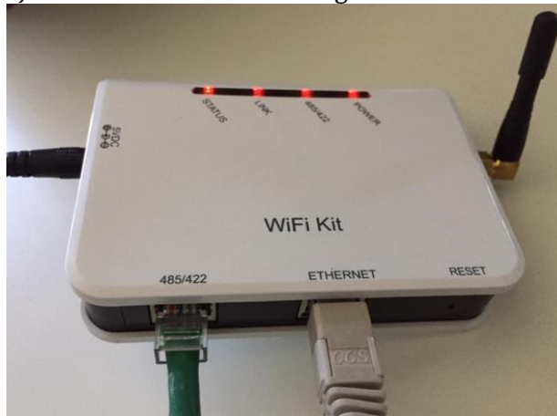
Figura 81 - Cavo ethernet connesso al datalogger
