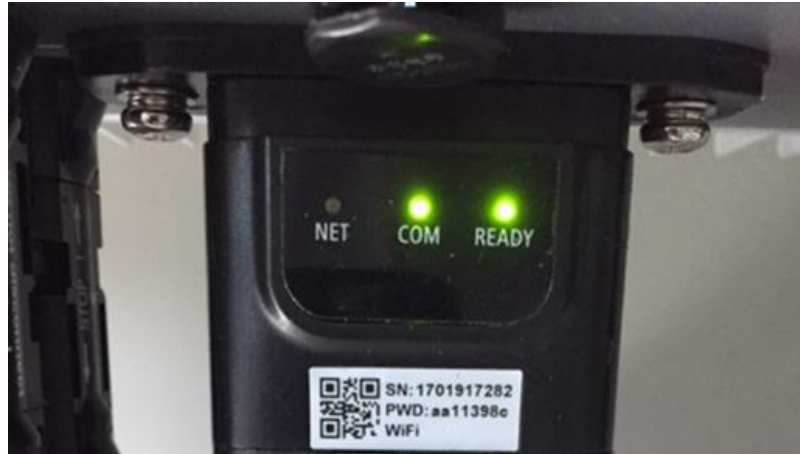
Figura 63 - Stato iniziale dei led
